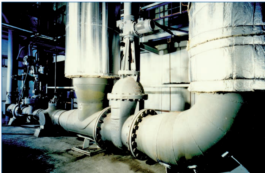
Jaderná elektrárna Temelín – redukční a chladicí stanice
