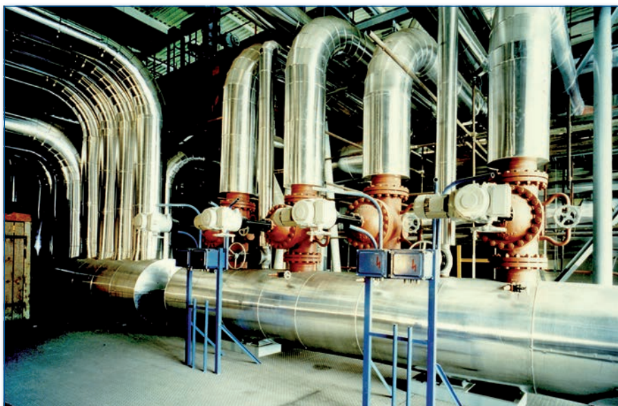
Jaderná elektrárna Temelín – rozdělovač v mezistrojovně
